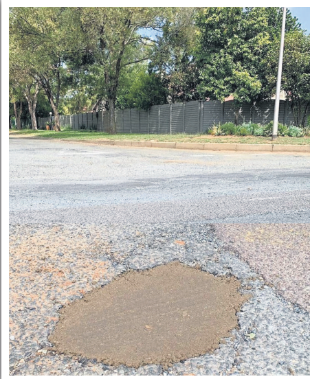
Sô lyk dit nadat 'n slagat met Pothole Fix opgevol is.
